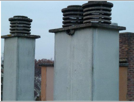
Photo n° PH02 Localisation : Toiture - Terrasse Ouvrage : Conduits, canalisations et accessoires intérieurs et extérieurs - Conduits de fluides (air, eau, vapeur, fumée, autres fluides) Partie d'ouvrage : Conduit Description : Canalisation d'évacuation
