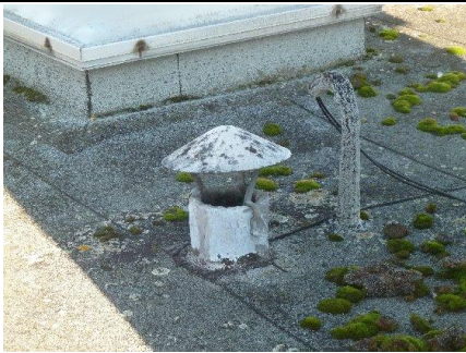
Photo n° PH01 Localisation : Toiture - Terrasse Ouvrage : Conduits, canalisations et accessoires intérieurs et extérieurs - Conduits de vapeur, fumée, échappement Partie d'ouvrage : Conduit + mitron Description : 3 Conduits + 3 mitrons
